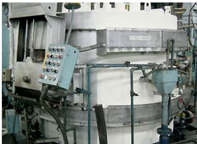
金属熱処理炉への断熱塗料使用例
