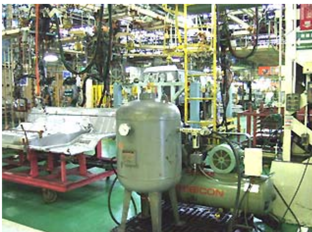
車体工場内の小型コンプレッサー使用例
