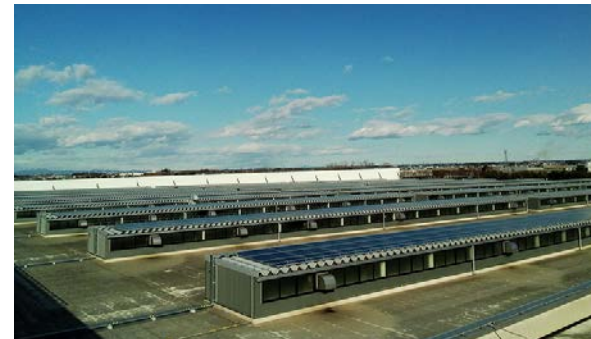
栃木工場の太陽光発電設備
