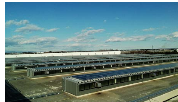
栃木工場の太陽光発電設備
